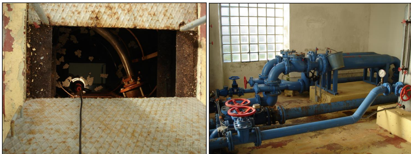
Photo 1: Vue intérieure du captage et des deux pompes
